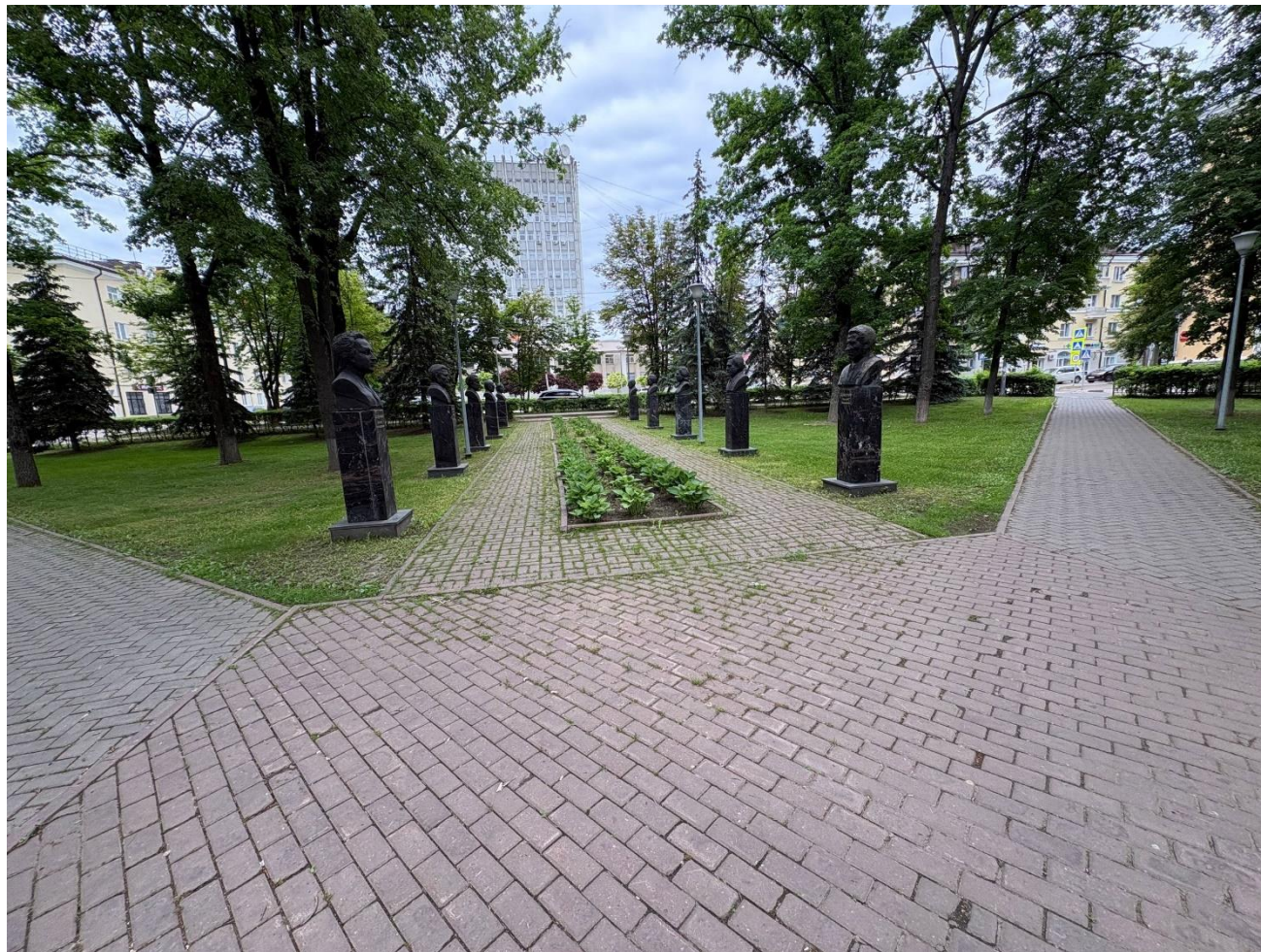
Плиточное покрытие в неудовлетворительном состоянии Отсутствие мест отдыха
