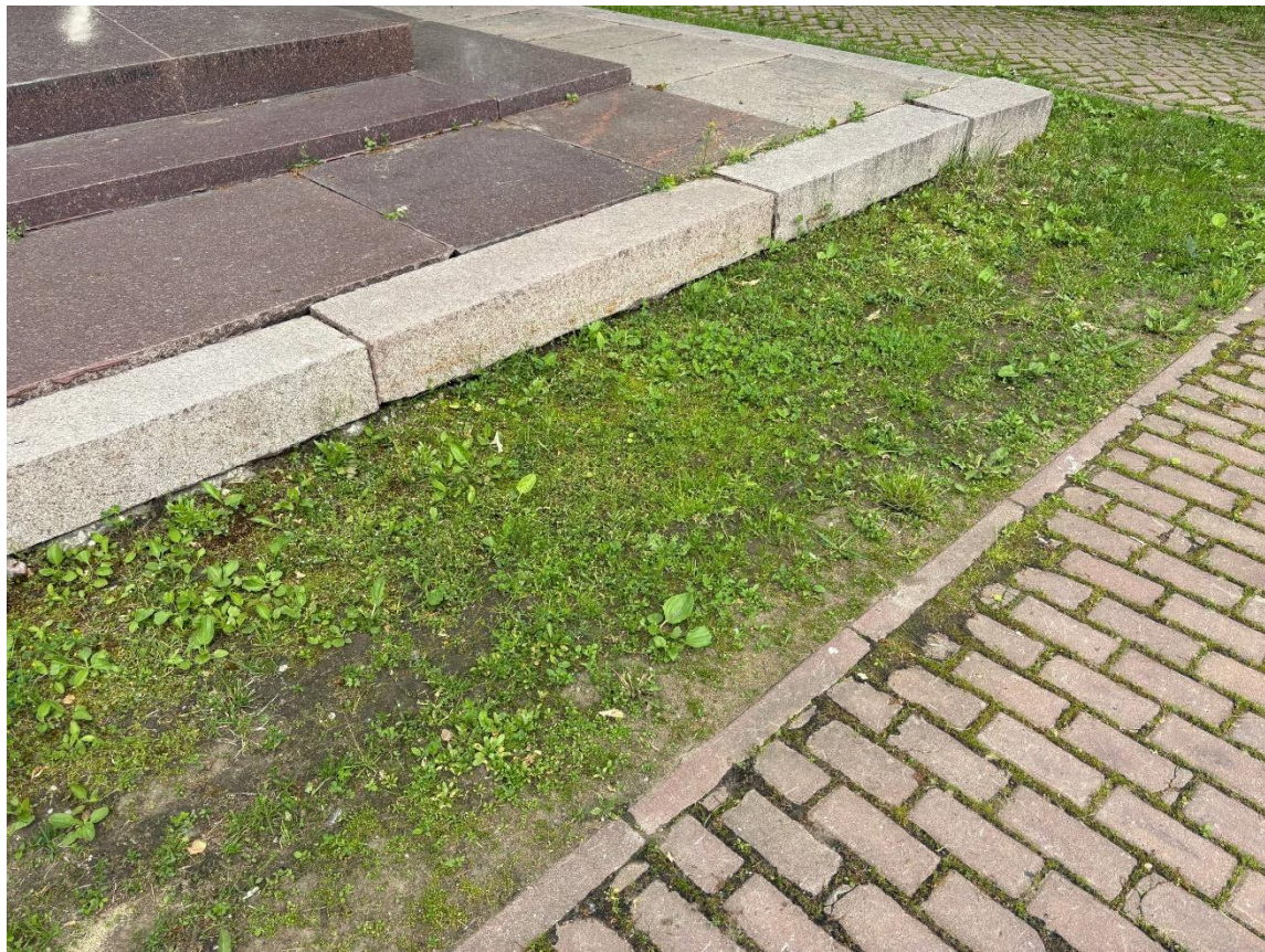
Травяной покров, бордюры в неудовлетворительном состоянии
